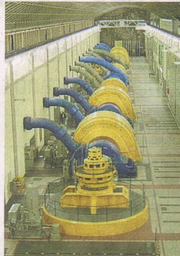
La centrale di Santa Massenza
